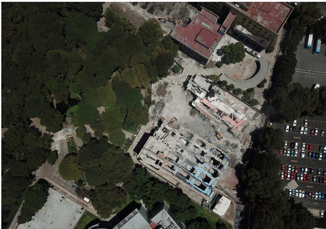
Imagen 146: Vista aérea de edificación dañada. Fuente: Lucía Vergara 2017.
