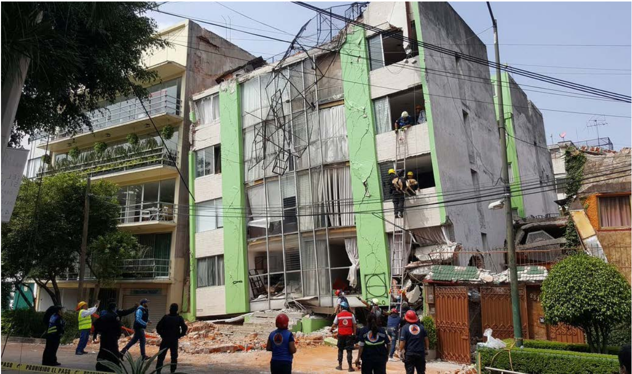
Imagen 140: Edificio colapsado por falla de planta baja débil. Fuente: Twitter de la Alcaldía Benito Juárez 2017, @BJAlcaldia.
